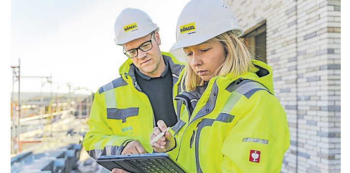
Arbeitsplatz mit Aussicht: Vorarbeiter Markus Engel und Büro-Mitarbeiterin Vivian Speller auf der Dachterrasse der Medienquartier-Baustelle.
